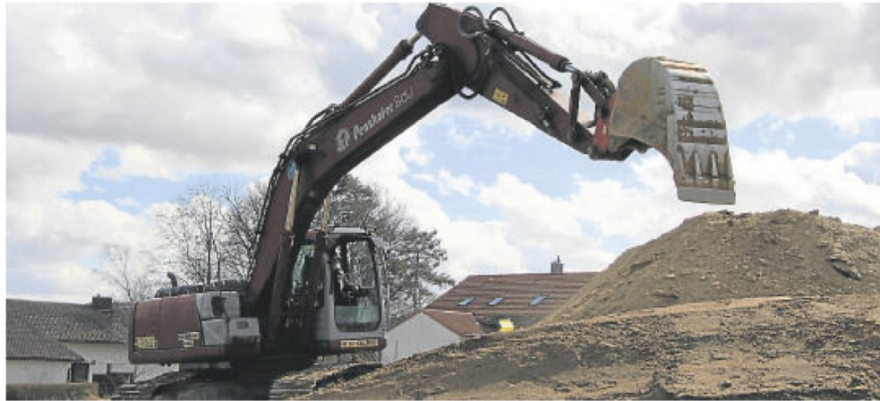
Baustart am Grubhügel: Im neuen Wohngebiet, das Alexander Penzkofer zwischen Bärndorf und Grubhügel für Familien aus der Region plant, wird bereits die Baugrube für das erste Wohnhaus ausgehoben.
