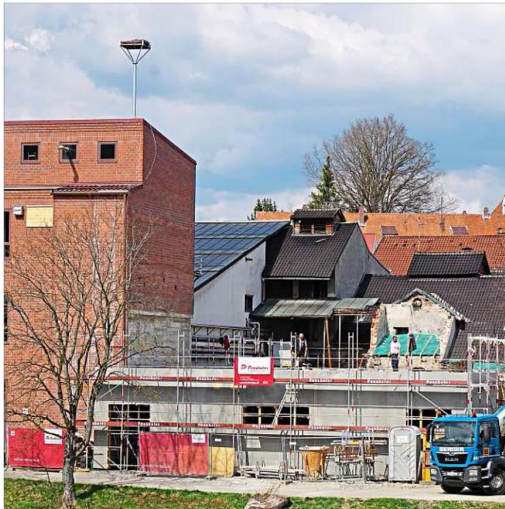
Von der Badstraße aus ist die Baustelle des neuen Gär- und Lagergebäudes der Brauerei Falter gut zu sehen. Das Erdgeschoss steht, bereits Ende April soll Richtfest sein. Ein neues „Gebäude“ ist bereits fertig, das Nest des Storchenpaares, das auf dem Metallgestell thront, das die Penzkofer-Arbeiter im vergangenen Jahr auf das Dach des Sudhauses (links im Bild) montiert haben. – Fotos: Lukaschik
