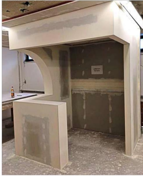
Wie vielseitig die Arbeit als Trockenbauer ist, zeigte Hermann Löffelmann bei seinem Meisterstück. Er gestaltete einen Kubus mit Tür übers Eck, Deckenfries und anderen Extras. – Foto: Löffelmann
