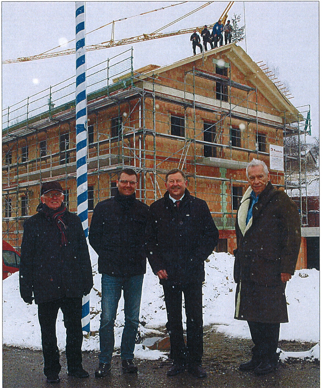
Freuen sich über den Baufortschritt am Blossersberger Keller: vorne (von rechts) Bauherr Günther Klein, 3. Landrat Heinrich Schmidt, Generalunternehmer Alexander Penzkofer und 3. Bürgermeister Walter Schlicht, oben beim Richtbaum die Zimmerer um Bauleiter Wilhelm Loibl (Zweiter von rechts). – Foto: Schlamming
