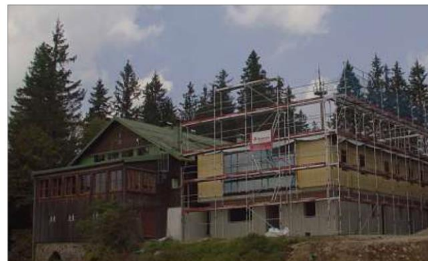
Die Roharbeiten am Schutzhaus sollen bis Anfang September abgeschlossen werden. – Foto: Susanne Ebner
