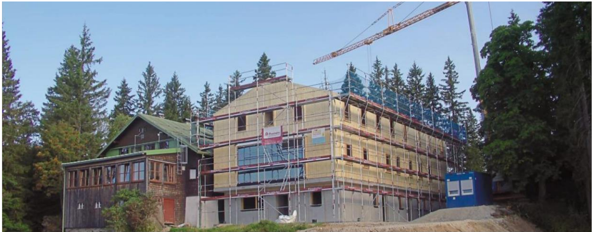
In Rekordzeit zum Richtfest: Der Rohbau für das neue Schutzhaus auf dem Falkenstein ist nur sieben Wochen nach dem Spatenstich fast fertig, das massive Sichtdach ist schon drauf. Fotos: Ebner
