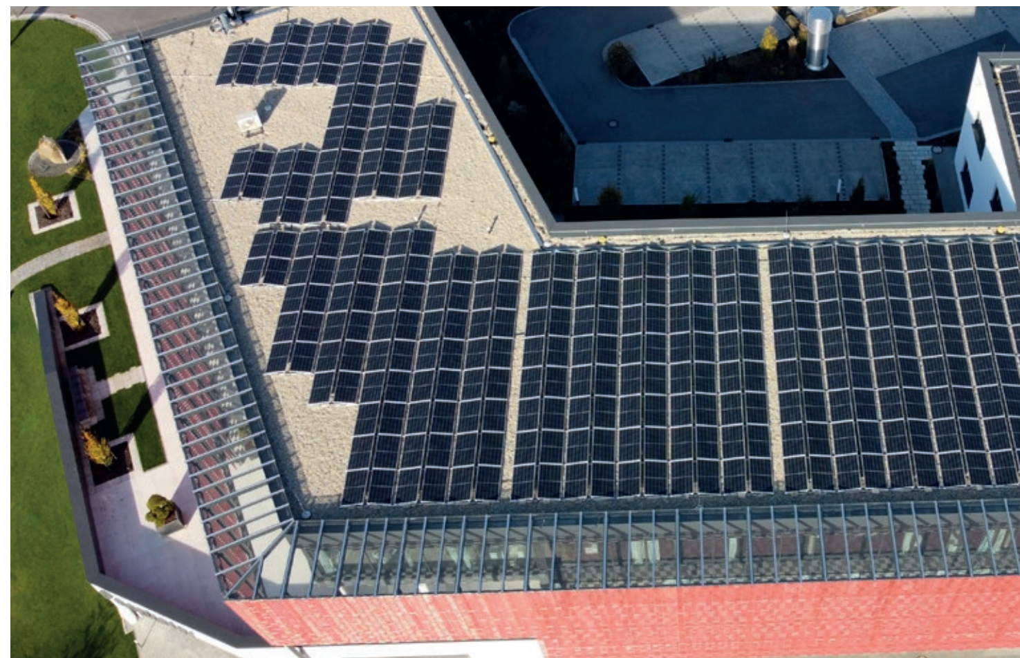
Sonnenenergie/Photovoltaikanlage zur Stromgewinnung im Bürogebäude
